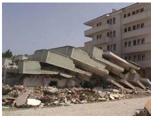
Фиг.1.3. Разрушени сгради вследствие продънване на плочата, Измит, Турция, 1999 г. ( http://www.britannica.com/event/Izmit-earthquake-of-1999 )
