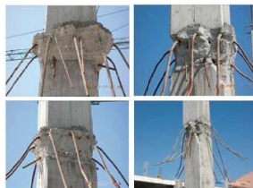
Фиг.1.2 Разрушена връзка колона – гладка плоча [103]
